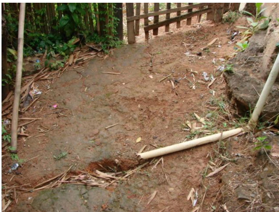
Figura 07: Canalização irregular de águas servidas descartadas inadequadamente no talude. Foto do setor 11 , nas proximidades do Bairro Resende.
