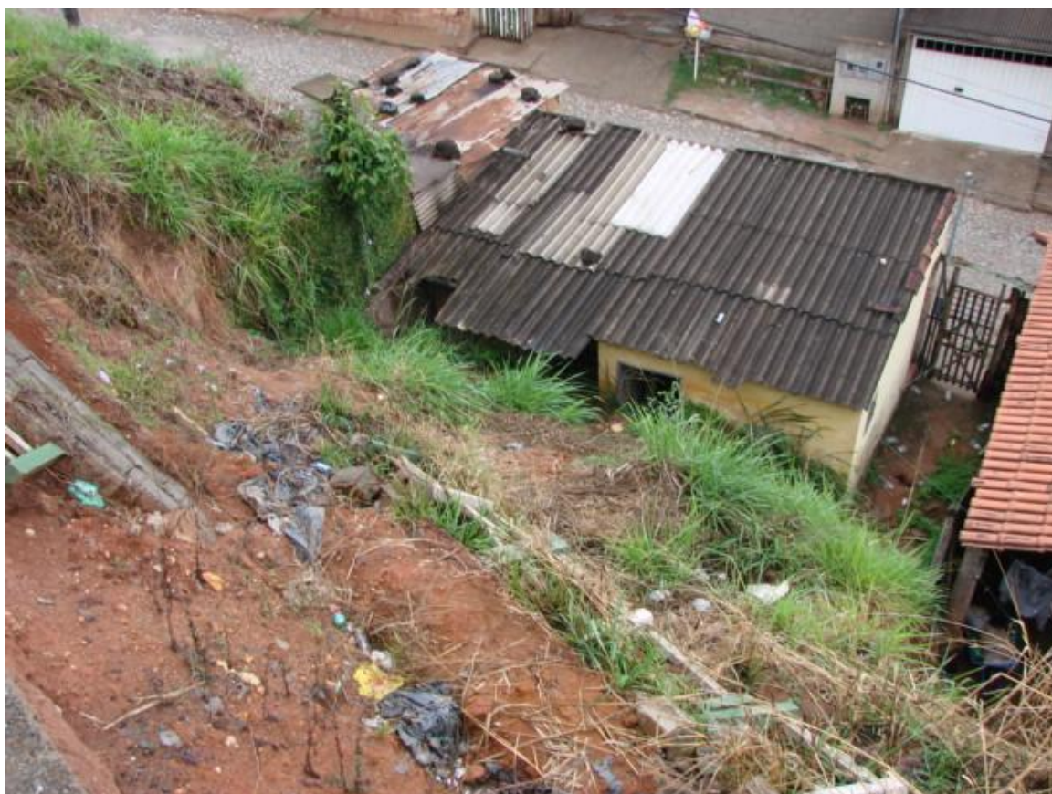
Figura 04: Exemplo de setor classificado como do tipo muito alto. Talude sub-vertical (>45°) com sulcos erosivos. Evidências de processos de movimentos de massa lentos, como trincas no terreno e nas residências, localizadas no topo do talude, e árvores inclinadas. Estas feições demonstram que os processos de movimentos de massa se encontram em franco andamento. Todos esses fatores aliados ao histórico de deslizamento no local condicionam o setor como muito alto. Foto do Setor 01 (proximidades do Hotel do Ouro, Bairro Morro da Cruz).
