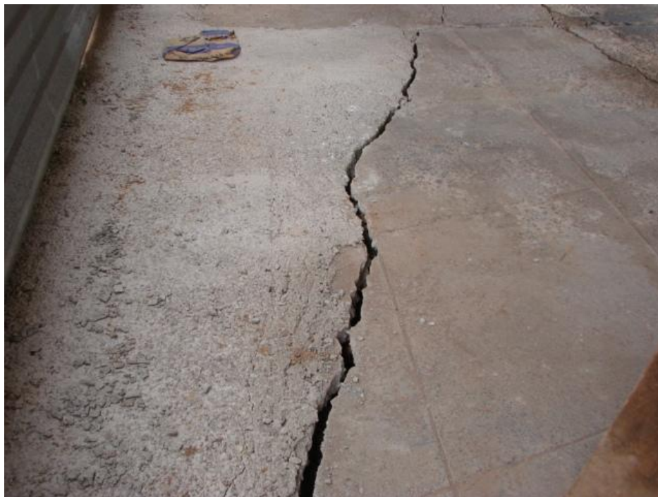
Figura 06: Trincas no terreno das residências evidenciam processos de movimentação de massa lentos, que afetam a estrutura das construções. Foto do Setor 10 , na região central da sede.
