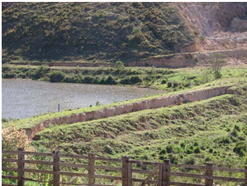
Figura 08: Foto da barragem na Fazenda Morro Grande em Buarque de Macedo. Os degraus de abatimento evidenciam que a barragem está cedendo, podendo alagar o distrito de Buarque de Macedo.
